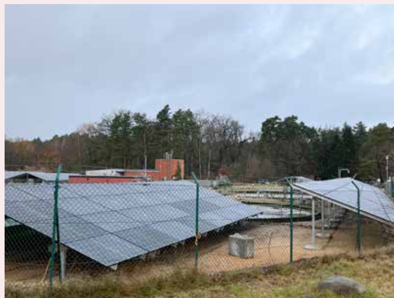
Solaranlage am Klärwerk Amelinghausen
